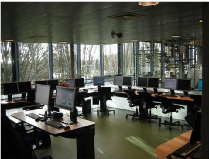
Afbeelding 3: operator bedieningsstations in de controlekamer
