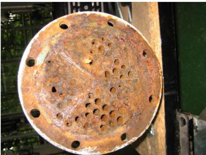
Afbeelding 4: Inwendige vervuiling en corrosie van de pijpen in een warmtewisselaar
